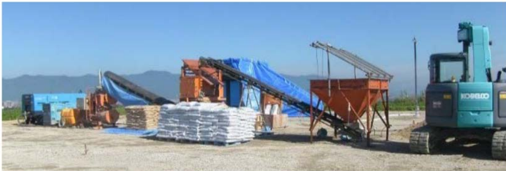
吹付プラント全景
